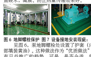
图 6 地脚螺栓保护 图 7 设备接地安装瑕疵
