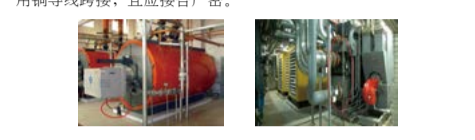
图 19 燃油管道系统防静电接地和法兰处镀锌螺栓连接
